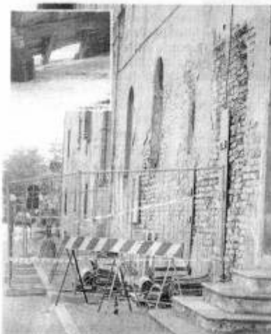
La messa in sicurezza della strada sottostante al comicione da cui sono cadute le tegole
